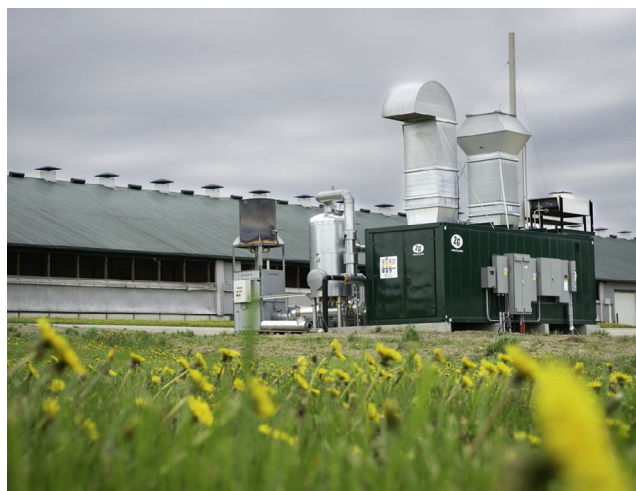
Les unités de cogénération au biogaz augmentent l'efficacité de la production de biométhane Source : 2G Energy AG
